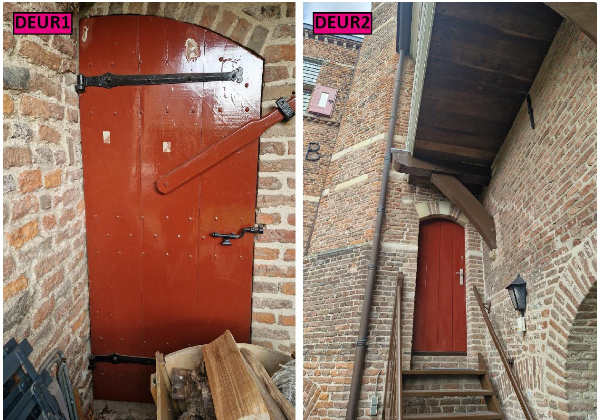
Figuur 36. Foto's van de twee deuren (zie vorige figuur). Deur 1 is oud (ca. 1940) en deur 2 is nieuw (ca. 1980).
