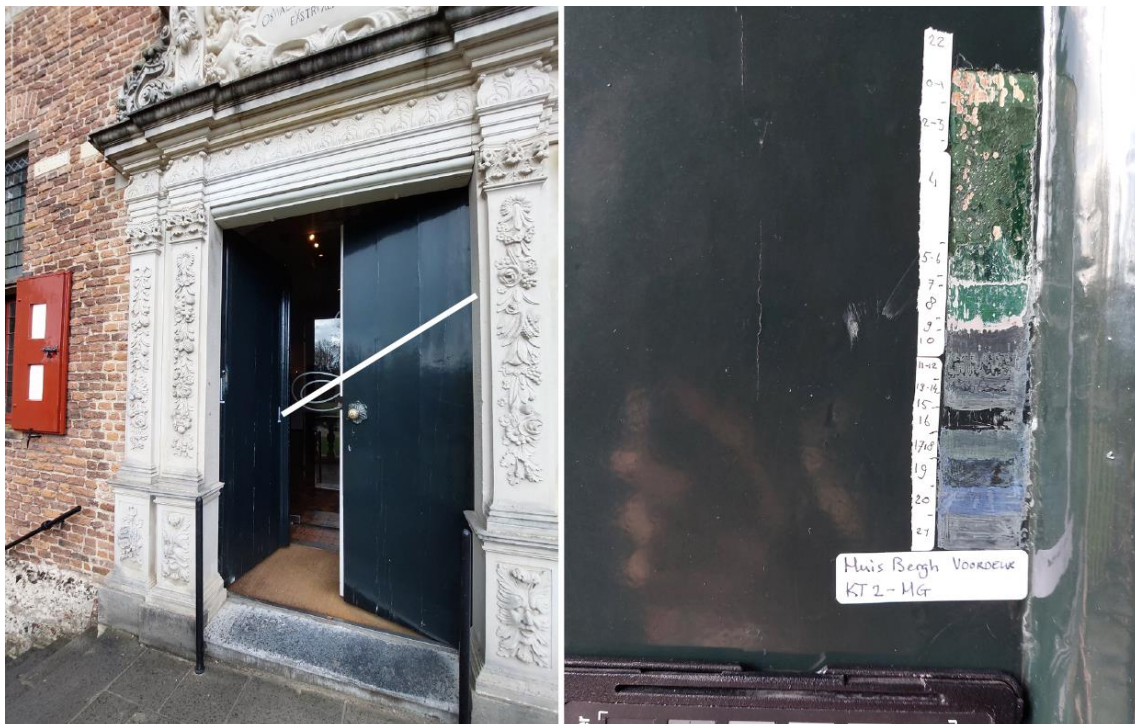
Figuur 63. Kleurtrap op de voorzijde van de voordeur. Enkel het pakket tot net onder de afwerking van 1940 is aanwezig. Het lijkt erop dat de voorzijde van de deur grondig is afgekrabd na de brand.
