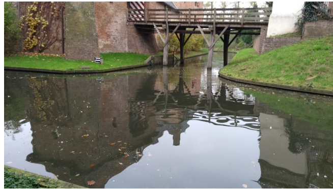
Figuur 3.3 (rechts). De oever van de gracht bij de toegangspoort aan de oostzijde.. Er is duidelijk te zien dat de beschoeiing boven het water uitkomt.
